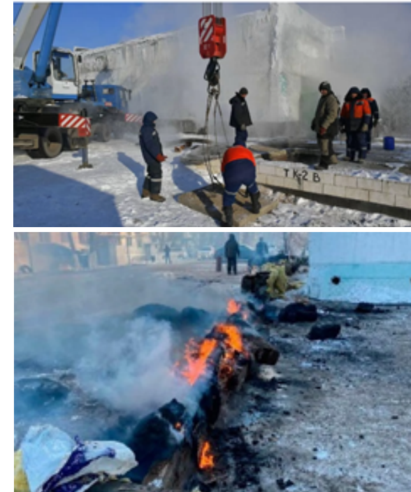
Сурет 2 – Екібастұзда зардап шеккен үйлер. Жылу құбырларына жөндеу жұмыстары жүргізілу сәтінен 07.12.2022 жыл
